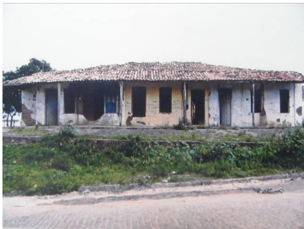
Figura 1 – Suposto núcleo original da fazenda Santana dos Olhos d’Água, construído no século XVIII, em ruínas devido às ações do tempo
